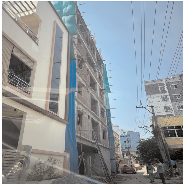
రామ్ నరేష్ నగర్ లో ఫ్లాట్ నెంబర్ 3 ఎలాంటి అనుమతులు లేకుండా నిర్మిస్తున్న నిర్మాణం
