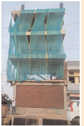
ఆలంపల్లి రోడ్డులో అక్రమంగా కొనసాగుతున్న భవన నిర్మాణం
