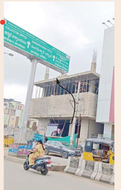
సూర్య నగర్ రోడ్డులో కళ్యాణ్ జువెలరీస్ పక్కనే రోడ్డును ఆక్రమించి నిర్మాణం ఇలా
